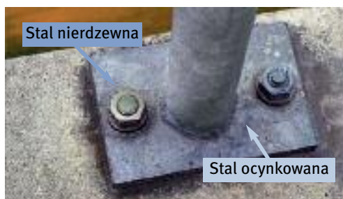
Rysunek 8a, 8b: Elementy złączne ze stali nierdzewnej na dużo większym elemencie ze stali ocynkowanej zwykle nie powodują korozji.
