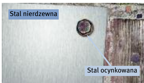
Rysunek 10a, 10b: Praktyczne przykłady sytuacji z rysunku 9 (ocynkowana stal węglowa stykająca się ze stalą nierdzewną w środowisku atmosfery morskiej).
